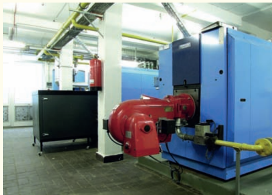
Zentralheizungsanlage in einem gewobau Wohngebäude in der Robert-Bunsen-Straße
