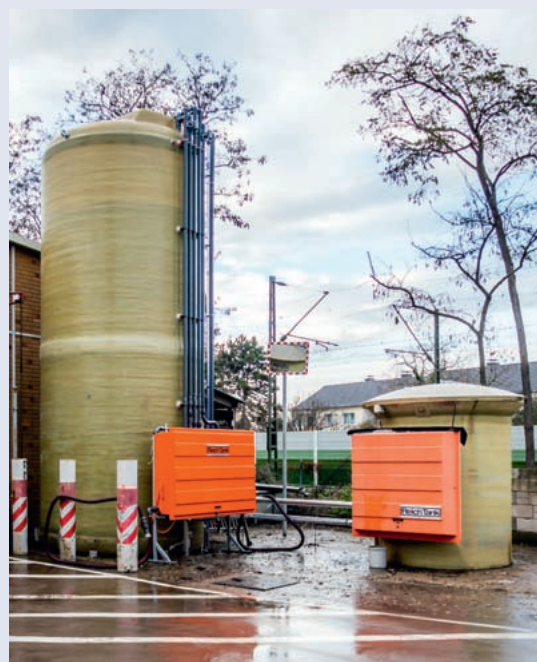
Die neue Laugenmischanlage des Städteservice Raunheim Rüsselsheim: Wird Lauge entnommen, produziert die Anlage selbstständig bis zu 3.000 Liter in der Stunde nach.
