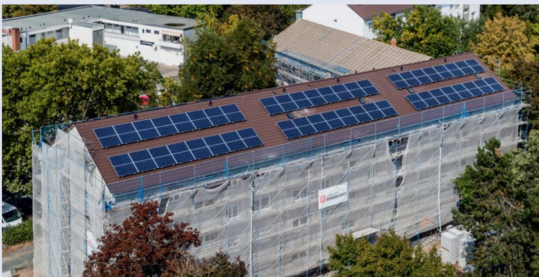
Blick auf die Photovoltaikanlagen auf den Dächern im Hessenring 15 - 19
