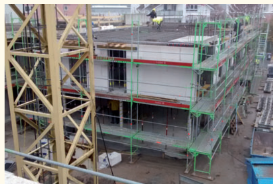
SWA Bauschheim: Die neuen Baukörper sind schon erkennbar. Das Erdgeschoss wird derzeit gemauert.
