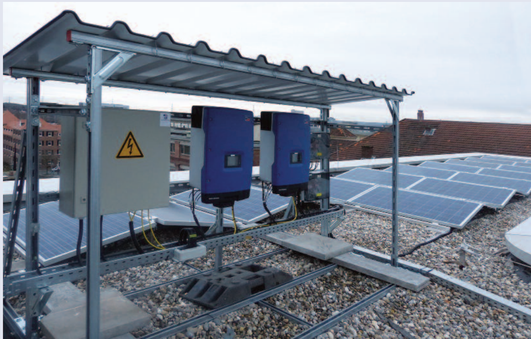
Neuester Stand: Dach der gewobau-Geschäftsstelle mit zukunftsweisender Photovoltaikanlage
